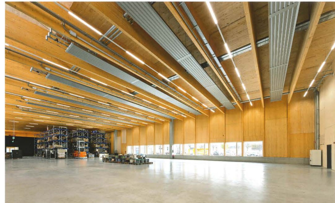
Die Beheizung im Hallenbereich erfolgt hauptsächlich über Deckenstrahlplatten zwischen den Holzbindern des Tragwerks.
